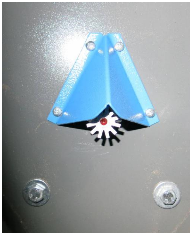
а) система пожаротушения в бункере
